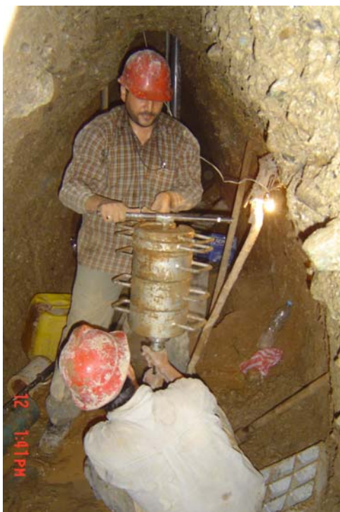
شکل 5- بکارگیری ابزار نفوذ وزنی سوئدی در یک گالری حفر شده در آبرفتهای درشت دانه تهران (چشمی، 1385)
