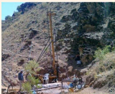
ایستگاه تزریق آزمایشی
